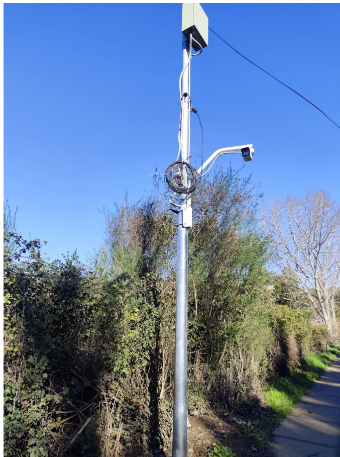
Cámara bullet IP fijada al brazo, orientada al eje del camino
