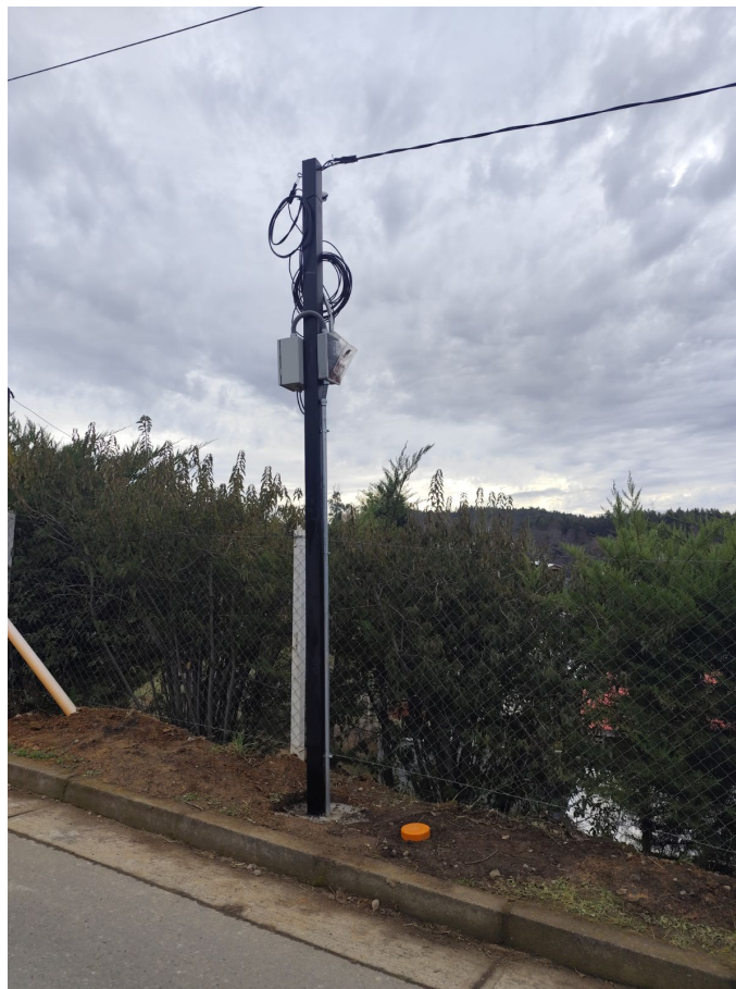
Caja de conexiones estanca y cableado con reserva en el poste
